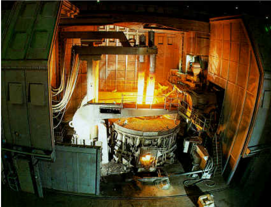
Figura 1. Horno de arco de c.a. Se pueden apreciar en la parte superior de la imagen los electrodos que se introducen en la cuba, así como los portaelectrodos que los sujetan y los cables flexibles que provienen del secundario del transformador. Cortesía de DANIELI.
